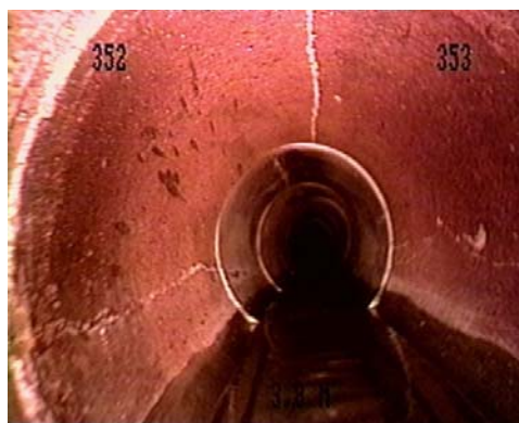
Figure 14 – Fissures longitudinales à 12 h, 3 h et 9 h
