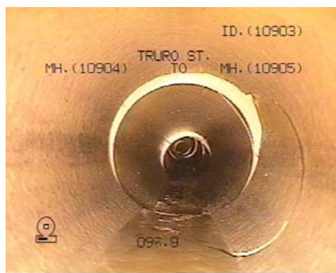
Figure 13 – Exemple d'une fissure circulaire
