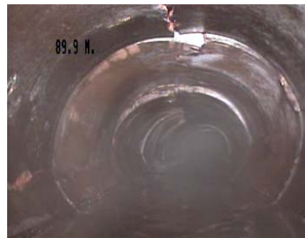
Figure 21 – Exemple d'une conduite déformée
