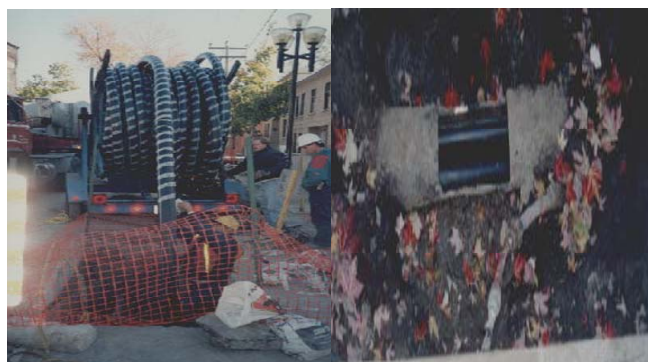
Figure 51 – Exemple de tubage déformé
