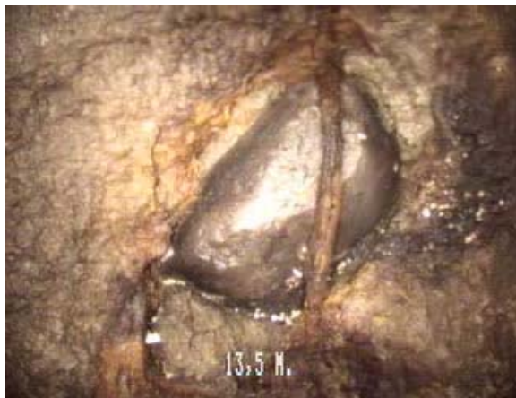
Figure 67 – (Photo 7) Éclat de surface avec armature visible
