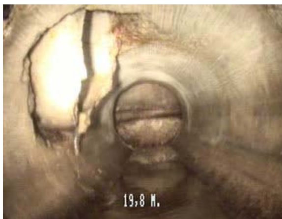
Figure 72 – (Photo 4) Raccordement pénétrant et défectueux
