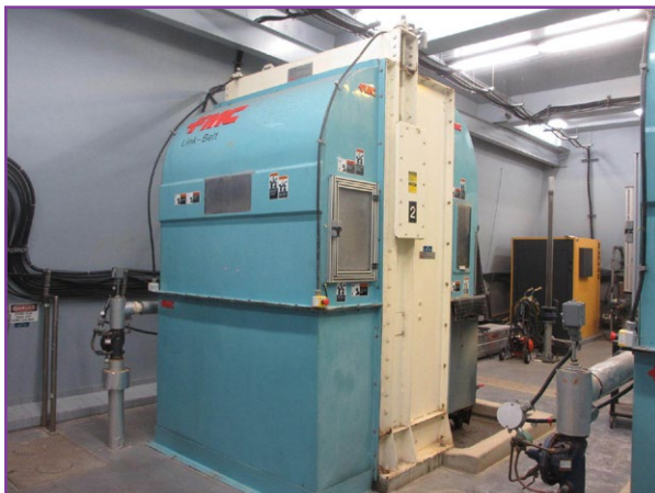
Figure 7 : Dégrilleur (eau brute)
