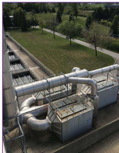
Figure 64 : Système de traitement de l'air (au charbon)
