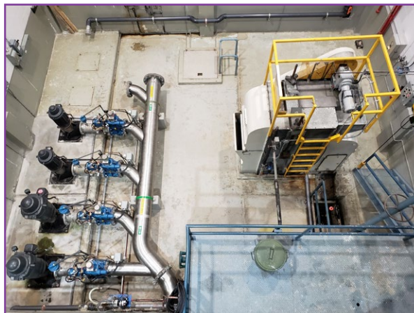
Figure 8 : Pompes d'eau brute
