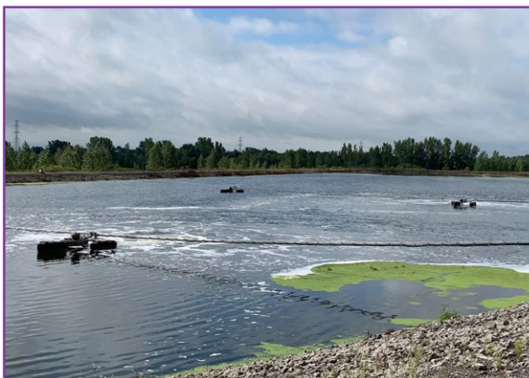
Figure 55 : Aérateurs de surface d'un étang
