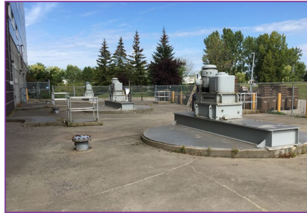
Figure 57 : Bassins de stockage
