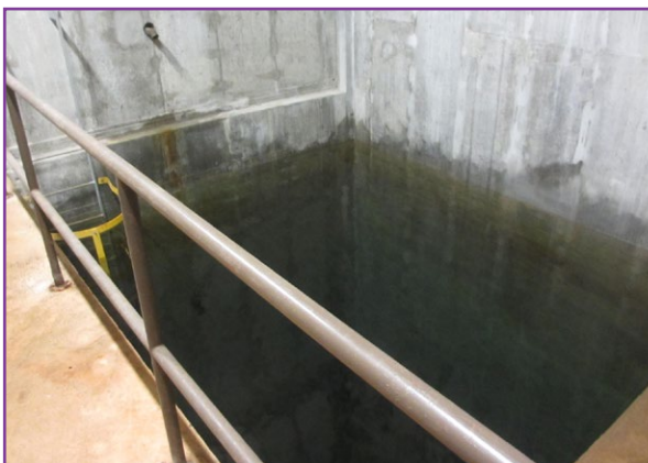
Figure 33: Réservoir d'eau traitée (vue intérieure)
