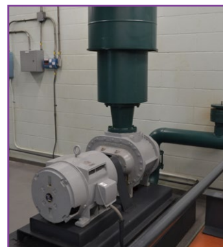
Figure 24 : Surpresseur de lavage
