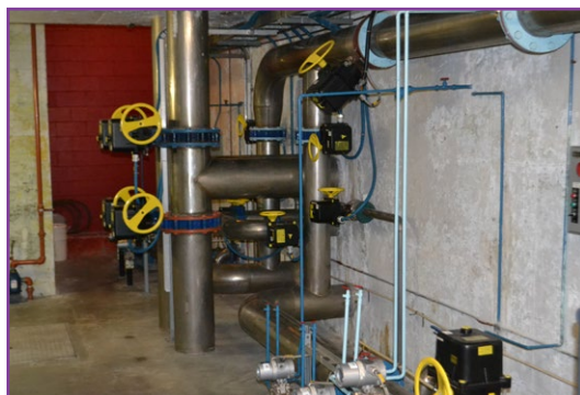
Figure 22 : Galerie de filtres
