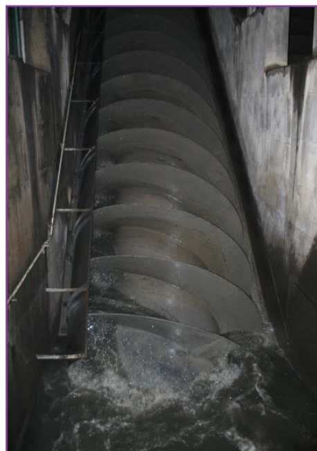
Figure 44 : Vis de relèvement des eaux usées
