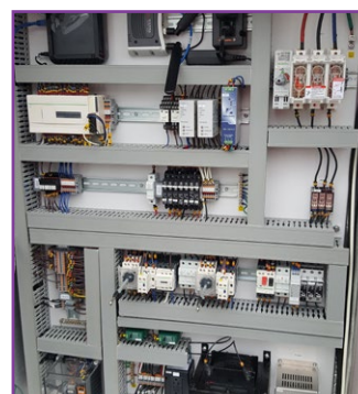
Figure 13: Automate de contrôle
