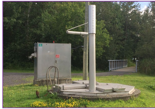
Figure 66 : Poste de pompage d'eaux usées
