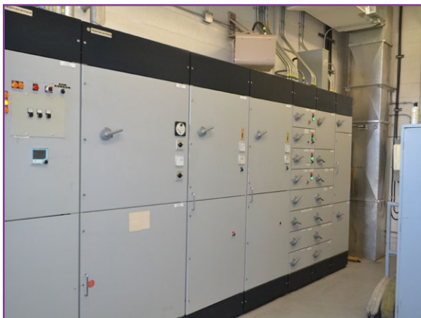
Figure 9 : Panneau d'alimentation électrique
