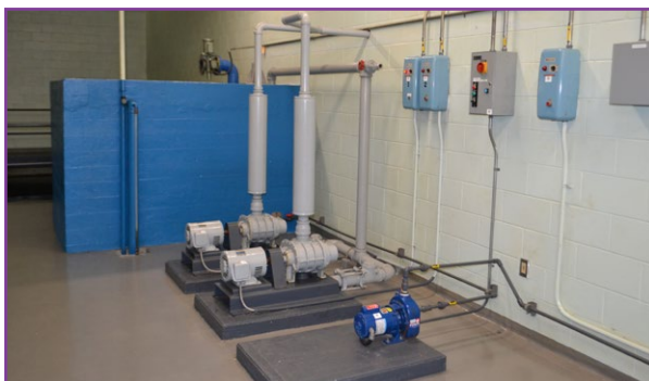
Figure 18: Pompes à vide de décanteur
