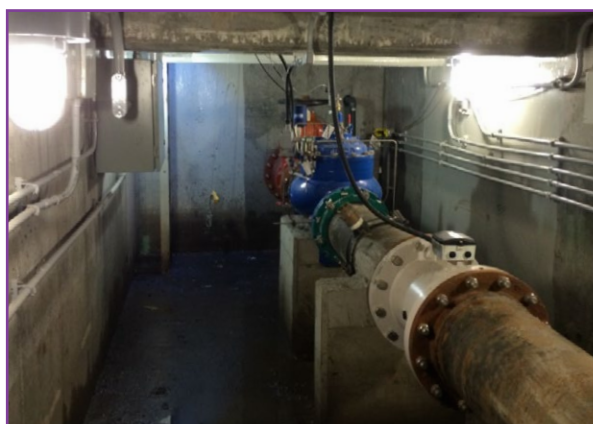
Figure 37: Poste de régulation de pression
