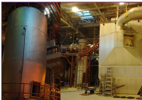
Figure 63 : Incinérateur (à lit fluidisé)
