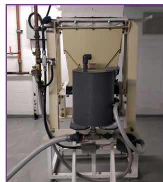
Figure 31 : Doseur de chaux
