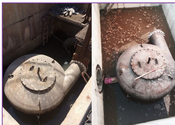
Figure 69: Vanne de régulation d'un ouvrage de surverse en eaux usées
