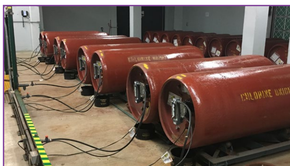
Figure 26: Stockage de produits de chloration
