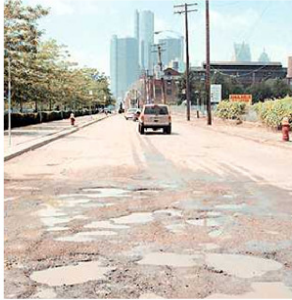
Fig. 2.2 : Accumulation de flaques d'eau en surface
