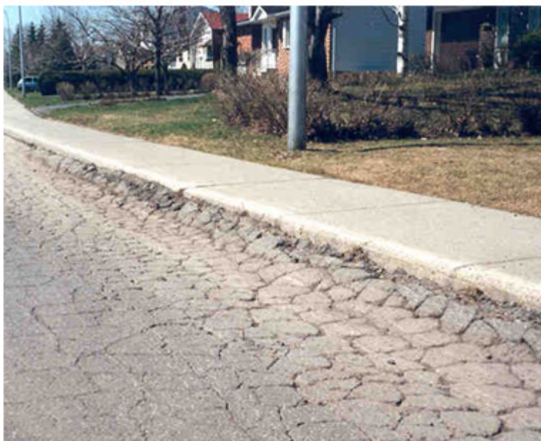
Fig. 1.6 : Chaussées endommagées par l'eau
