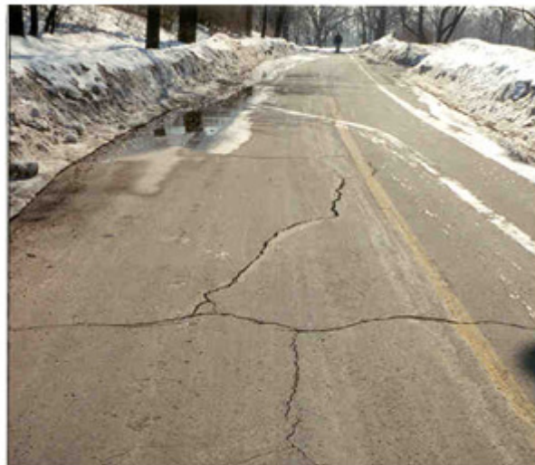
Figure A.2 : Chaussée gonflée
