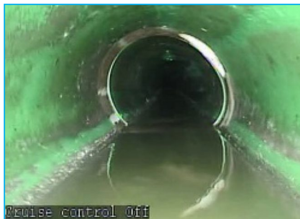
Figure 22 : Exemple d'une conduite déformée
