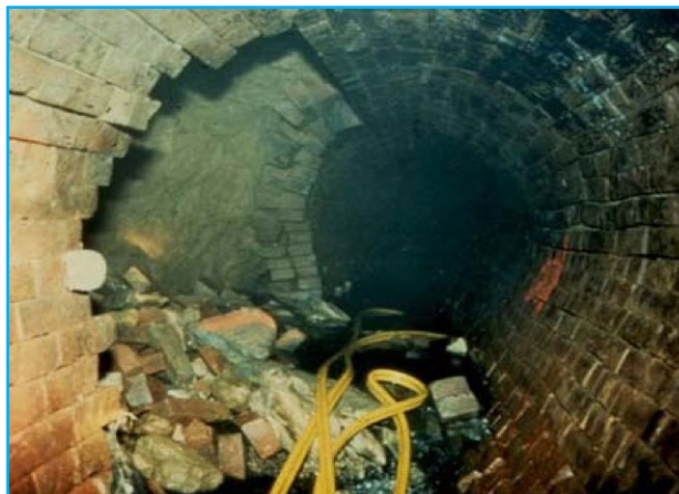
Figure 29 : Illustration d'un vide important dans le cas d'une conduite en brique
