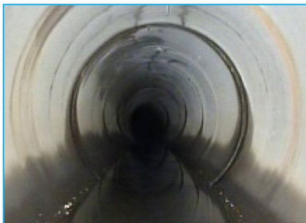
Figure 19: Exemple de fissures multiples de 11 h à 13 h
