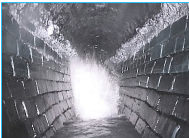
Figure 1: Exemple d'une conduite montrant des signes de mise-en-charge (dépôts graisseux de 10 h à 11 h et de 1 h à 2 h) (Ville de Montréal)
