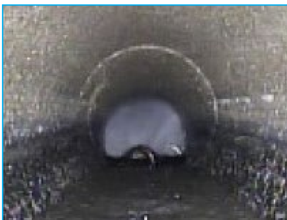
Figure 27 : Exemple d'abrasion du radier d'une conduite
