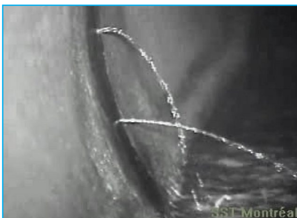
Figure 3 : Exemple d'une infiltration à travers un joint non étanche
