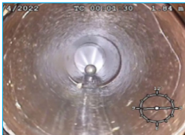
Figure 14: Exemple d'une fissure circulaire (source: Ville de Montréal)
