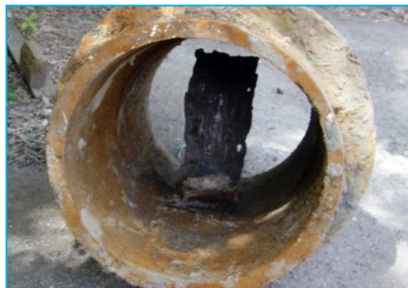
Figure 1.3: Obstruction de la conduite avec du plomb
