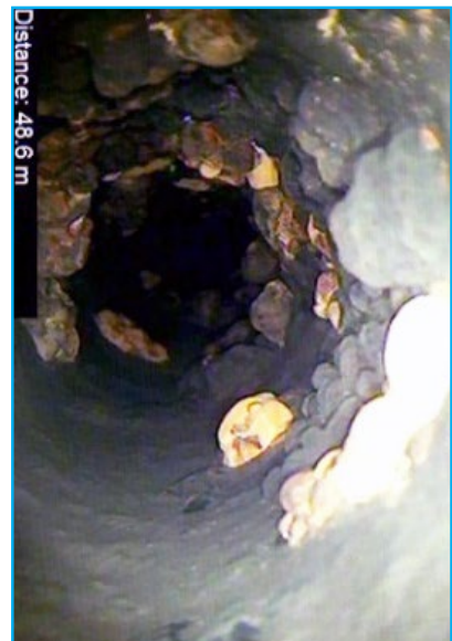
Figure 3.4: Inspection et détection de fuites sans interrompre le service – vue de l'intérieur (Consultants GAME)
