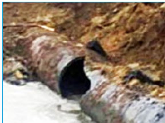
Figure 1.5: Rupture / Éclatement d'une conduite d'eau potable
