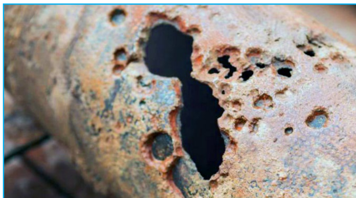
Figure 2.2: Corrosion de conduite métallique
