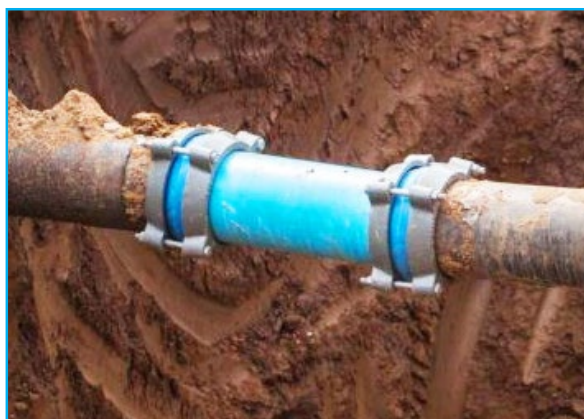
Figure 7.14 : Bris de conduite d'eau potable (Getty Images)
