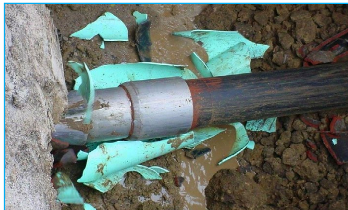
Figure 7.12: Éclatement d'une conduite (TT Technologies)
