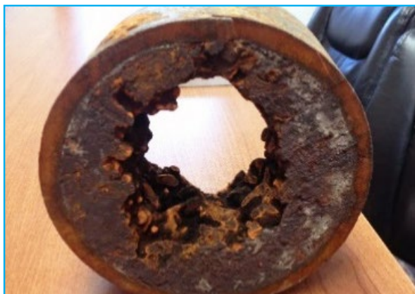
Figure 1.2: Obstruction de la conduite avec tubercules
