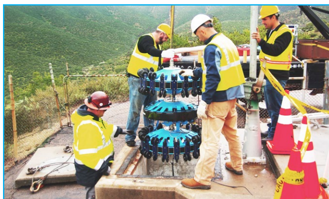
Figure 3.11 : Équipement avec câble pour mesurer l'épaisseur résiduelle de la conduite (PICA)
