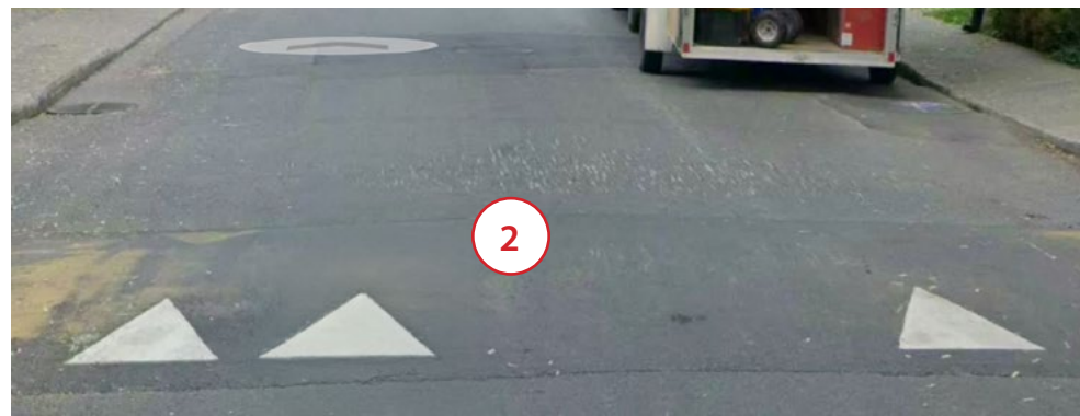
Figure 4 – Chaussée endommagée par un dos d'âne trop abrupt, avenue Macaulay, Saint-Lambert. Source : adaptée de Google Street View
