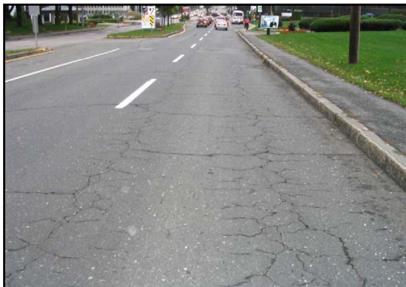
Rupture par fatigue
